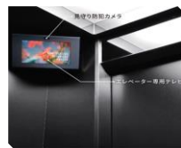
エレベーター
